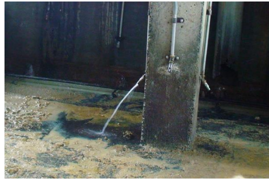
圖 4 飲水器持續漏水，顯示人員管理鬆散，並造成床面濕滑。
